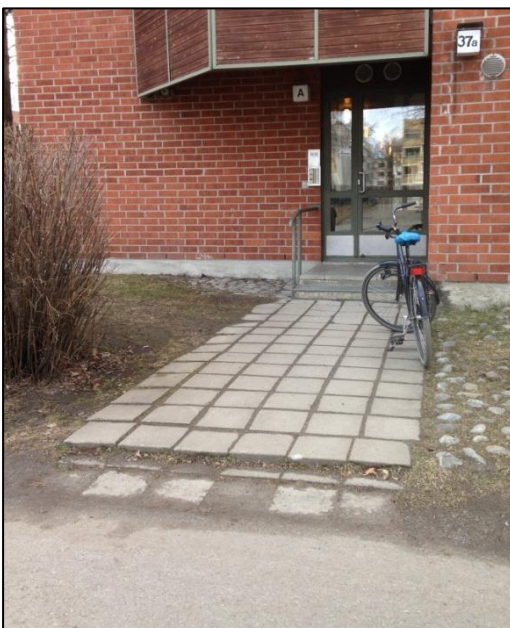
Kuva 146. Julkisivun puoleiselle sisäänkäynnille johtavan käytävän tasoitus tulee tarkistaa niin, että porrasaskelma jalkakäytävän päädyssä poistuu.
