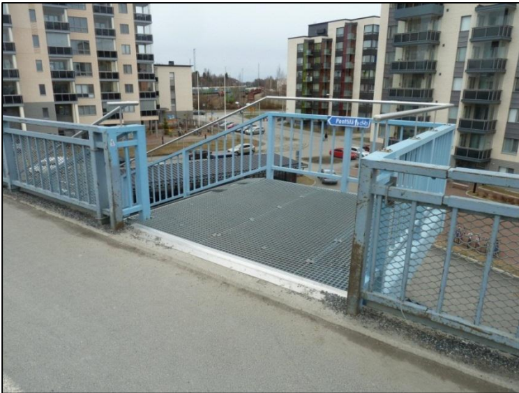
Kuva 37. Jalkakäytävän ja portaiden ylätasanteen välinen reunakivilinja ja metallinen kynnyks estävät näkövammaisen henkilön joutumisen vahingossa portaisiin.
