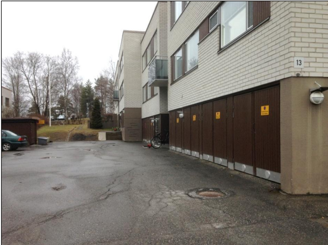
Kuva 147. Rakennuksen piha-alueen asfalttipäällyste on paikoin erittäin epätasainen.
