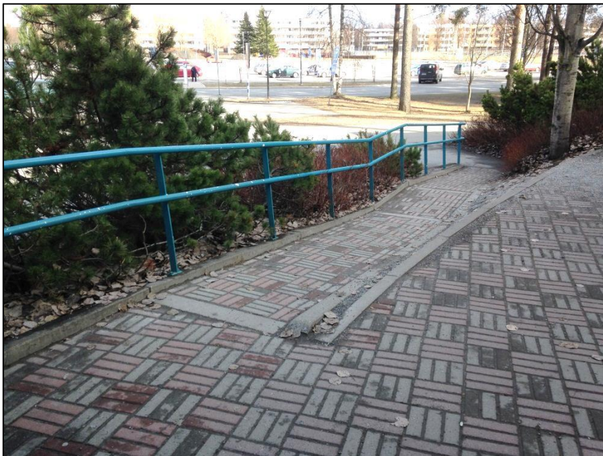
Kuva 134. Sisäänkäynnille johtavan luiskan ylätasanteella on putoamisvaara, koska ylätasanteen ja luiskan välissä ei ole kaidetta.
