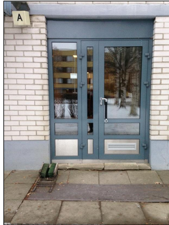
Kuva 142. Sisäänkäynneissä on erittäin korkeat kynnykset.
