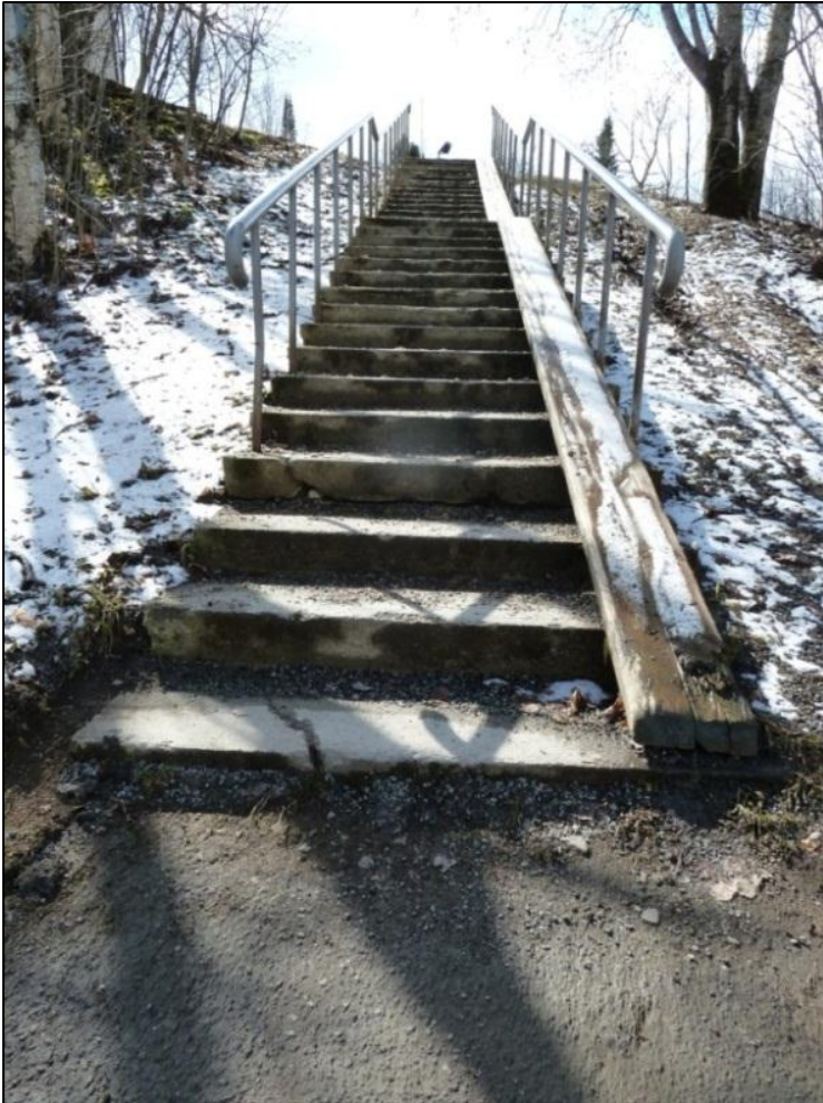
Kuva 63. Niinivaaranpuiston portaat ovat erittäin huonokuntoiset ja käsijohteet päättyvät ennen portaiden päättymistä.
