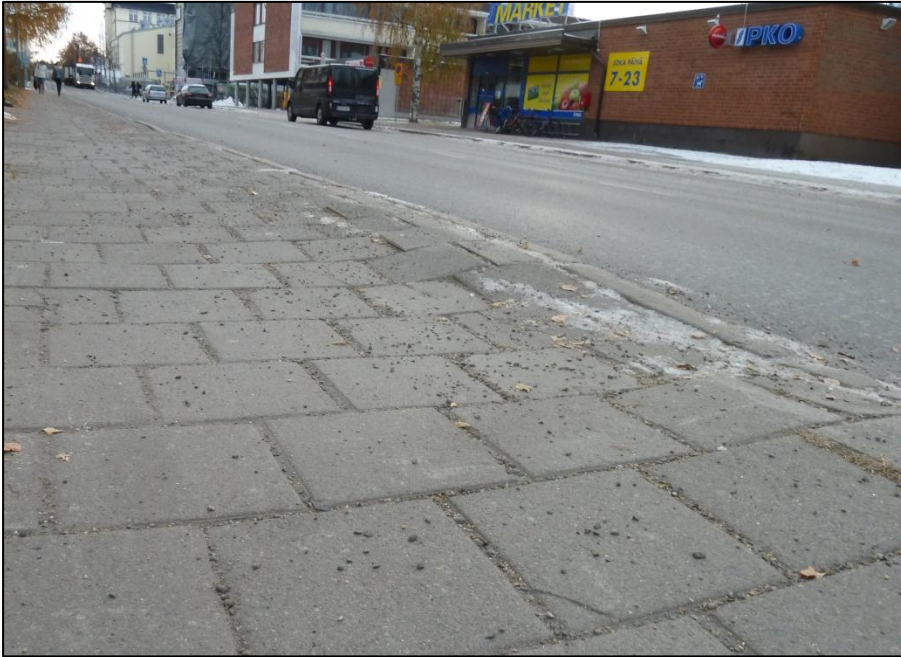
Kuva 12. Betonilaatoitus on monilla väyläosuksilla ajan kuluessa painunut. Kuva Papinkadulta.
