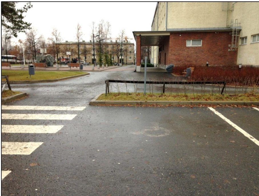
Kuva 113. Lyseon lukion le-pysäköintipaikalta puuttuu pystyopasteen taulu ja merkintä päällysteessä on kulunut.
