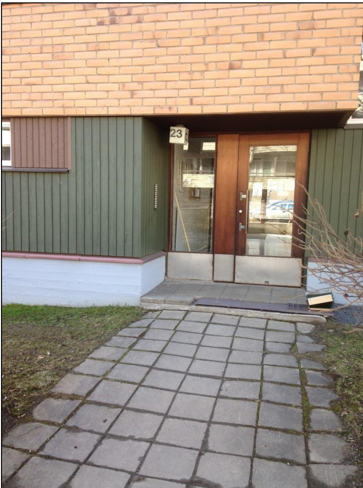
Kuva 143. Sisäänkäynneille johtavat laatoitetut käytävät ovat painuneet.
