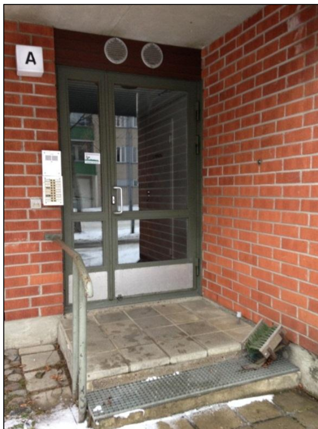
Kuva 144. Julkisivun puoleisen sisäänkäynnin käsijohde on ruosteinen.
