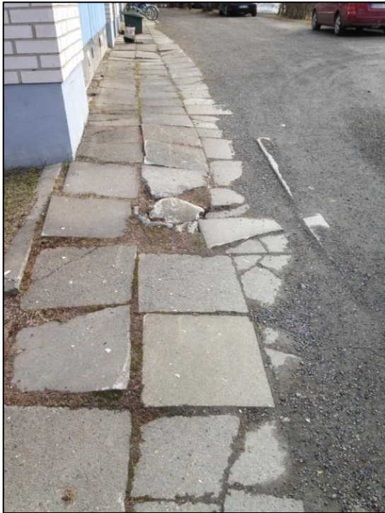
Kuva 141. Rakennuksen edustan laatoitusvyöhyke on erittäin painunut ja aiheuttaa kompastumisvaaran.
